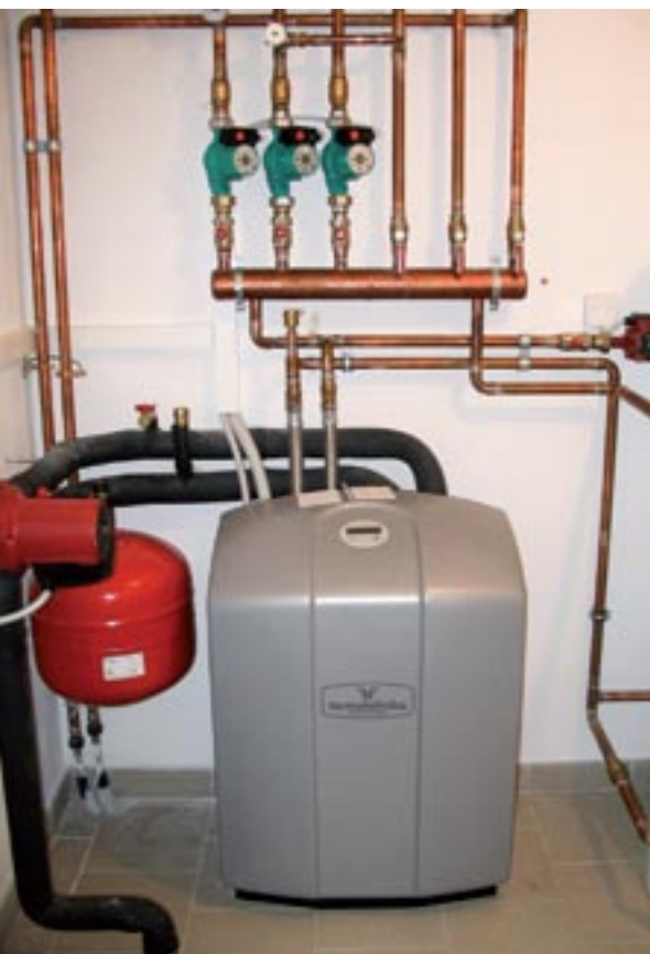
Slika prikazuje montirano toplotno opremo (toplotna črpalka, zalogovnik in bojler z vso potrebno instalacijo).
